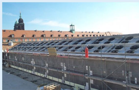
Aufbau der 20 Rückkühler in Schräglage; im Hintergrund sieht man die Türme der Dresdner Kreuzkirche und des Rathauses
