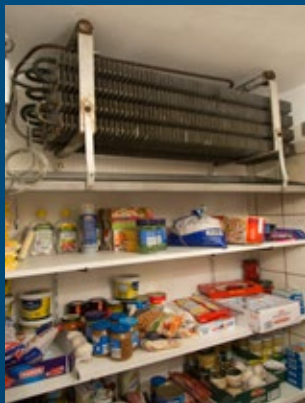
▲ Die Raumtemperatur des zweiten Kühlraumes beträgt 2 bis 4 °C
