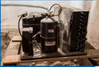
▲ Das L'unité Kälteaggregat mit dem Tecumseh Kompressor ist seit rund 30 Jahren in Betrieb.
