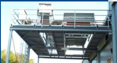
Verflüssiger auf einer Stahlkonstruktion
