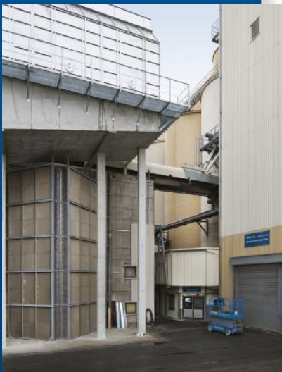
Zehn Güntner Luftherhitzeblöcke des Typs GCO (auf dem Bild noch ohne Verkleidung) erzeugen Warmluft für die Darre.
