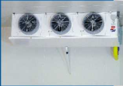
Die Güntner Vario CUBIC GHN im Kühllager haben eine nur geringe Temperaturdifferenz zwischen Zu- und Fortluft. Diese Betriebsweise wird gewählt, um beim rohen Obst und Gemüse Gewichtsverluste durch Verdunstung zu verhindern.
