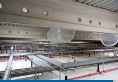
▲ Die umfangreiche Verrohrung, die Luftsäcke der CA-/ULO-Druckausgleichsanlage sowie die Trockensprinkler-Anlage befinden sich oberhalb der Lagerräume.
