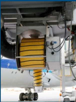
▲ Die Schlauchverbindung zwischen Flugzeug und festem Rohrsystem wird nach Betriebsende der PCA unter der Passagierbrücke zusammengerollt.
