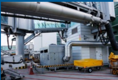
▲ Die Luft wird von der PCA über eine Kombination aus festem Rohr- und flexiblem Schlauchsystem mit hohem Druck in die engen Luftverteilssysteme des Flugzeugs gedrückt.
