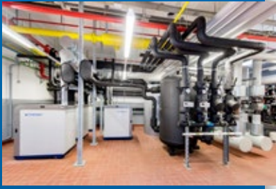
▲ Der Maschinenraum mit fünf Adsorptionskältemaschinen stellt im Miele-Werk in Bünde Klima-Kälte bereit.
