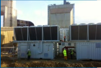
▲ Vier luftgekühlte Güntner V-SHAPE Vario Verflüssiger, Typ GVD, sind Bestandteil der Heatcatcher ORC-Anlage, die aus Abwärme Strom für den Eigenbedarf erzeugt.
