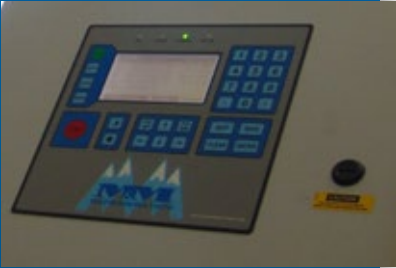
▲ Schaltschrank zur Steuerung der Kompressoren im Maschinenraum
