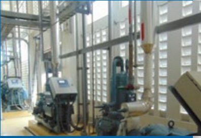
▲ NH 3 - und CO 2 -Kompressoren im Maschinenraum
