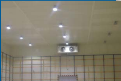
▲ Ein TK-Raum für 1.000 metrische Tonnen/1.102 amerikanische Tonnen wird von zwei Guntner CUBIC Vario CPGHN Verdampfern gekühlt, die an beiden Enden des Raums ineinander gegenüber angebracht sind.
