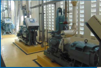
▲ NH 3 - und CO 2 -Kompressoren im Maschinenraum.
