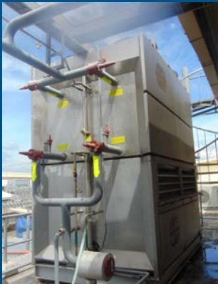
▲ Zwei Guntner ECOSS Verdunstungsverflüssiger geben die überschüssige Wärme der NH 3 -Kompressoren an die Umgebung ab.
