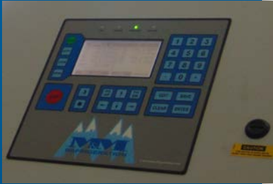
▲ Schaltschrank zur Steuerung der Kompressoren im Maschinenraum.
