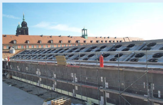
Aufbau der 20 Rückkühler in Schräglage; im Hintergrund sieht man die Türme der Dresdner Kreuzkirche und des Rathauses
