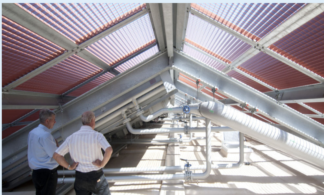
Ansicht der Rückkühler nach Einbau des Sichtschutzes
