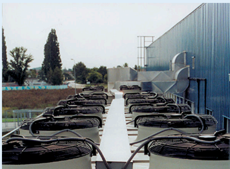
Die Verflüssigereinheiten sind direkt über der Kältezentrale auf dem Dach angeordnet; im Hintergrund die Lüftungszentrale.
