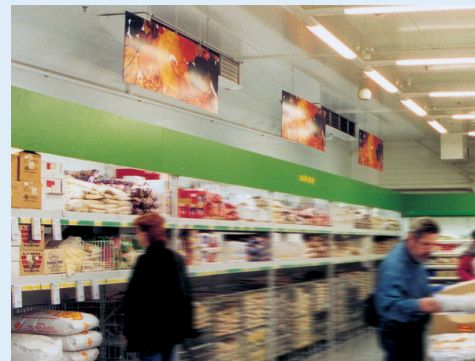
Einseitig ausblasende Deckenluftkühler GDF „low noise“ mit reduzierter Drehzahl sorgen für die notwendige Kühlung bei geringer Schallbelastigung.
