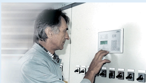
Die französische Servicefirma Optimal - s.v.o. betreut bei der Metro in Bratislava alle gebäudetechnischen Anlagen, auch die Kälteanlage.
