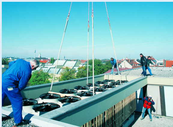
Installation eines der beiden GFD auf dem Dach der geologischen Institute der Ludwig-Maximilians-Universität
