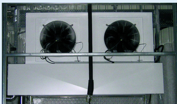
Luftkühler mit „Fallluftbetrieb“ in einem TK-Lager
