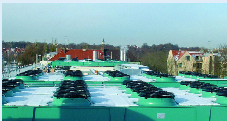
... bis hin zur Montage auf dem Dach des Rinecker Proton Therapy Centers.
