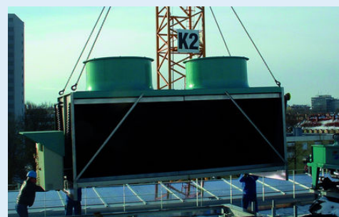
Hybridkühler von Jäggi/Güntner: Ideal für den Einsatz im Klinikbereich aufgrund der Legionellenfreiheit und des klinikgerechten Emissionsschutzes. Im Einsatz: 2 HTK vom Typ 1.8-52-2S-B6-BU-SX3
