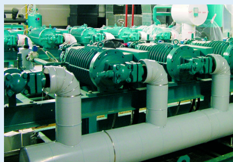
Der Maschinenraum mit Schockfrosterverbund vorne und Schnellkühlverbund hinten
