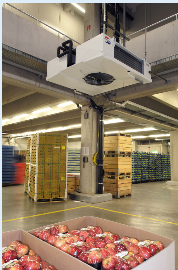
Kommissionierbereich: gute Kälteverteilung
