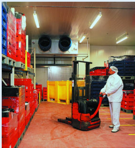
Der neue Einfrierraum der Achim Haas GmbH
