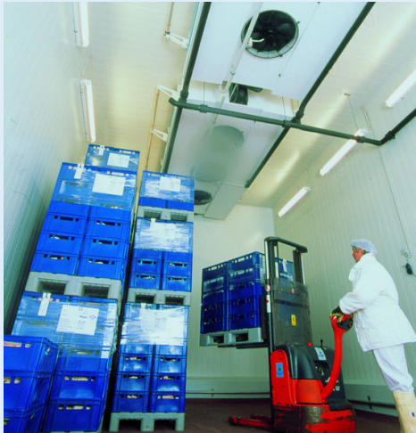
Güntner DHN mit geschlossenen Abtauklappen (hintere Verdampfer deutlich mit Überschusswärme)
