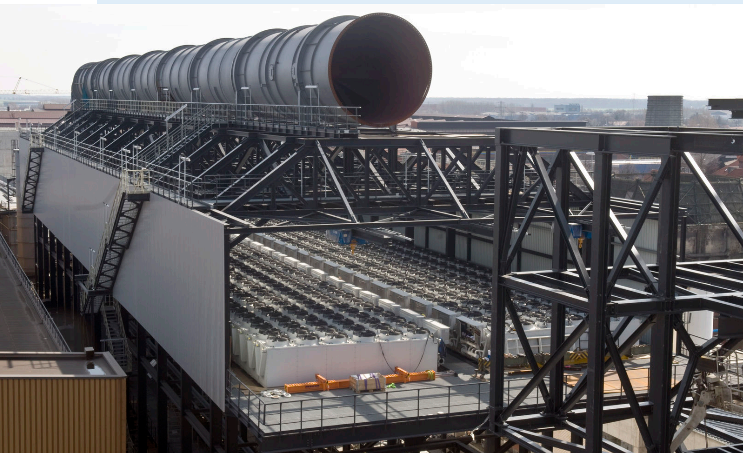
Güntner lieferte insgesamt 64 Rückkühler für diese Anlage.
