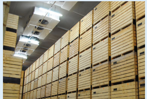
Kistenanordnung im Möhrenlager Greengrow mit den mittig im Raum montierten Doppelblock-Luftkühlern DGN
