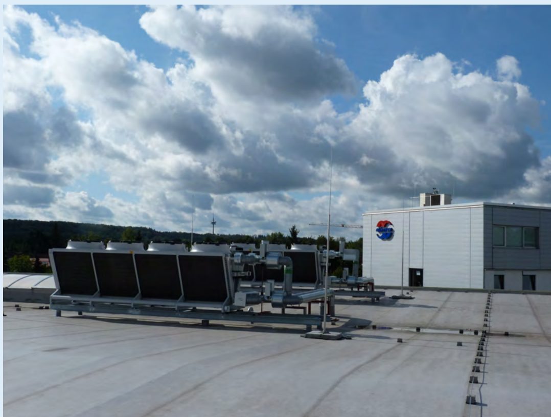
Als Rückkühler werden Güntner Geräte der Baureihe GFW eingesetzt.
