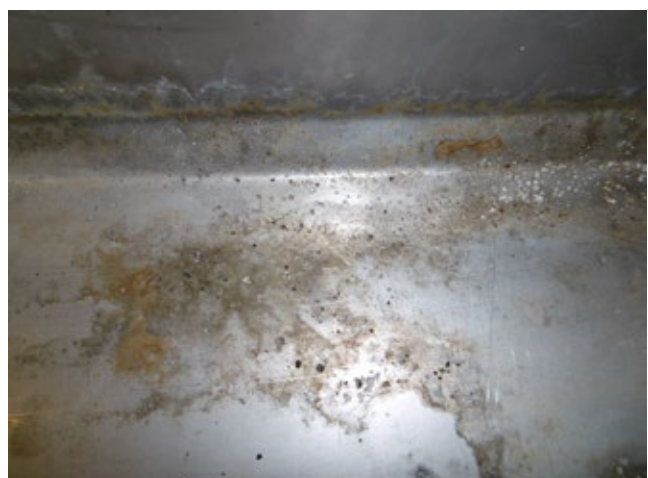
Abbildung 3: Die äußerlich eher unscheinbare Lochkorrosion verläuft nadelstichartig in die Tiefe des Materials.
