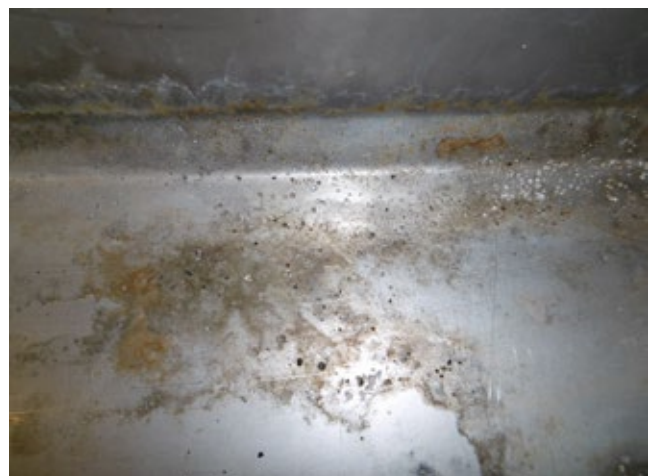
Fig. 3: La corrosión por picadura, que a nivel superficial parece inocua, se produce como si de una punción de una aguja se tratase en la profundidad del material.
